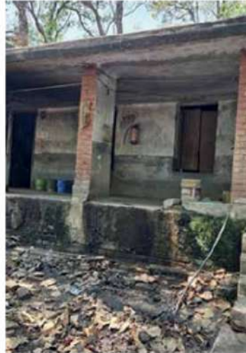
Eine sanierungsbedürftige Unterkunft: „Slumbewohner existieren für den Staat nicht“
